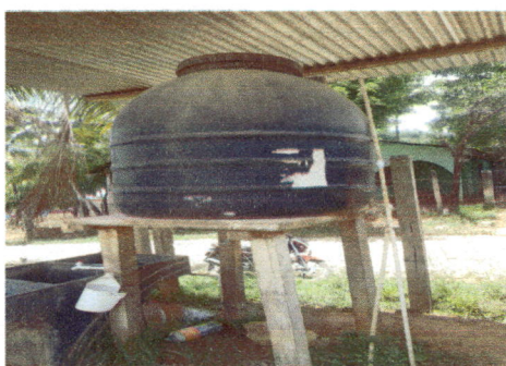
Foto 3: LA TARIMA DE LOS TINACOS SE ENCUENTRA YA EN MAL ESTADO SE MEJORARA CON UNA TARIMA DE CONCRETO CON BASES SEGURAS.
