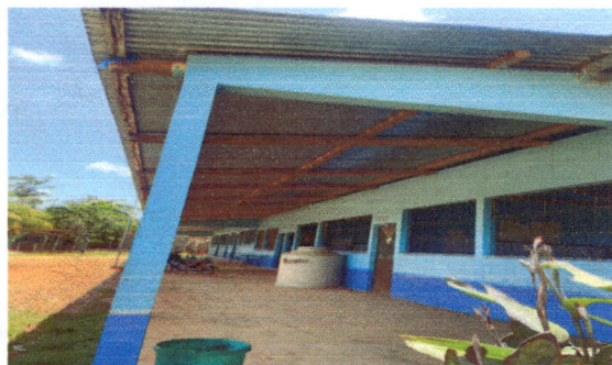
Foto 1: SE MEJORARA EL ENTECHADO DE TRES AULAS QUE SI ES PRIORIDAD TRABAJARLO EN TIEMPO DE INVIERNO AFECTA A LOS NIÑOS Y NIÑAS.
