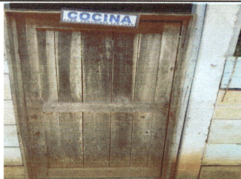
Foto 4: LA PUERTA DE LA COCINA ESTA DETERIORADA SE NECESITA MEJORAR CON UNA PUERTA DE METAL.
